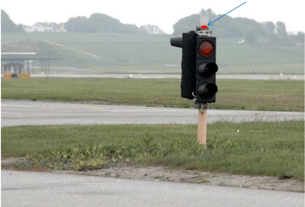
Venteposisjonslys for kjøretøy på Stavanger lufthavn, Sola
