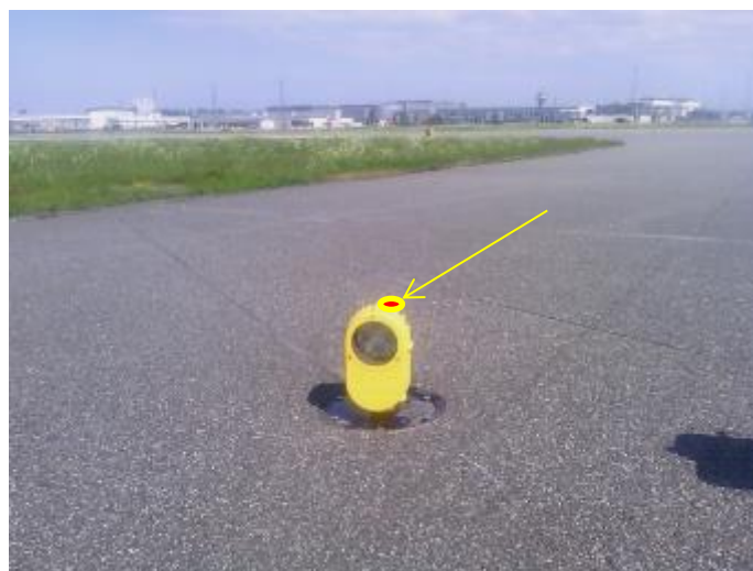
Stopplysrekke, opphøyd lys
