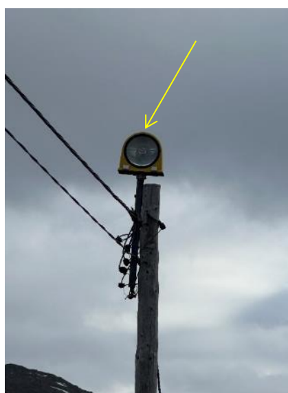
Høyre: SFL på Honningsvåg lufthavn, Valan
