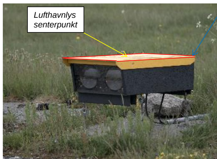
PAPI Visuelt glidebaneanlegg på Stavanger lufthavn, Sola
