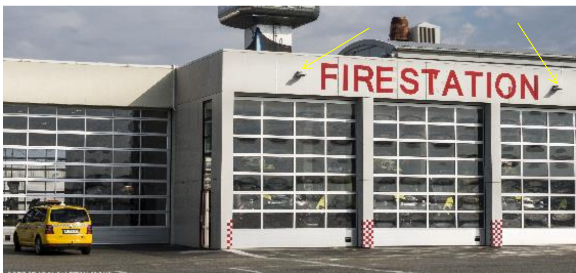
Flombelysning på vegg på Stavanger lufthavn, Sola
