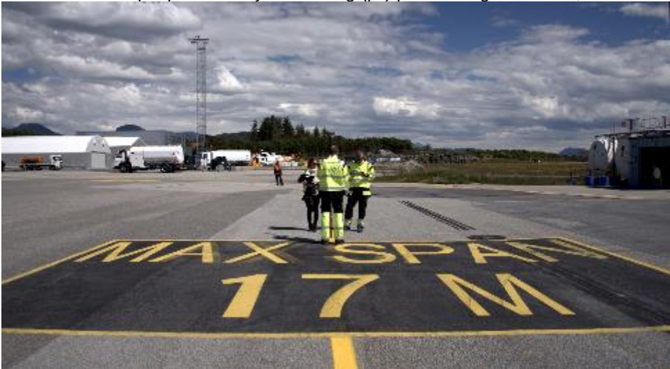
Eksempel på Instruksjonsmerking på Florø lufthamn
