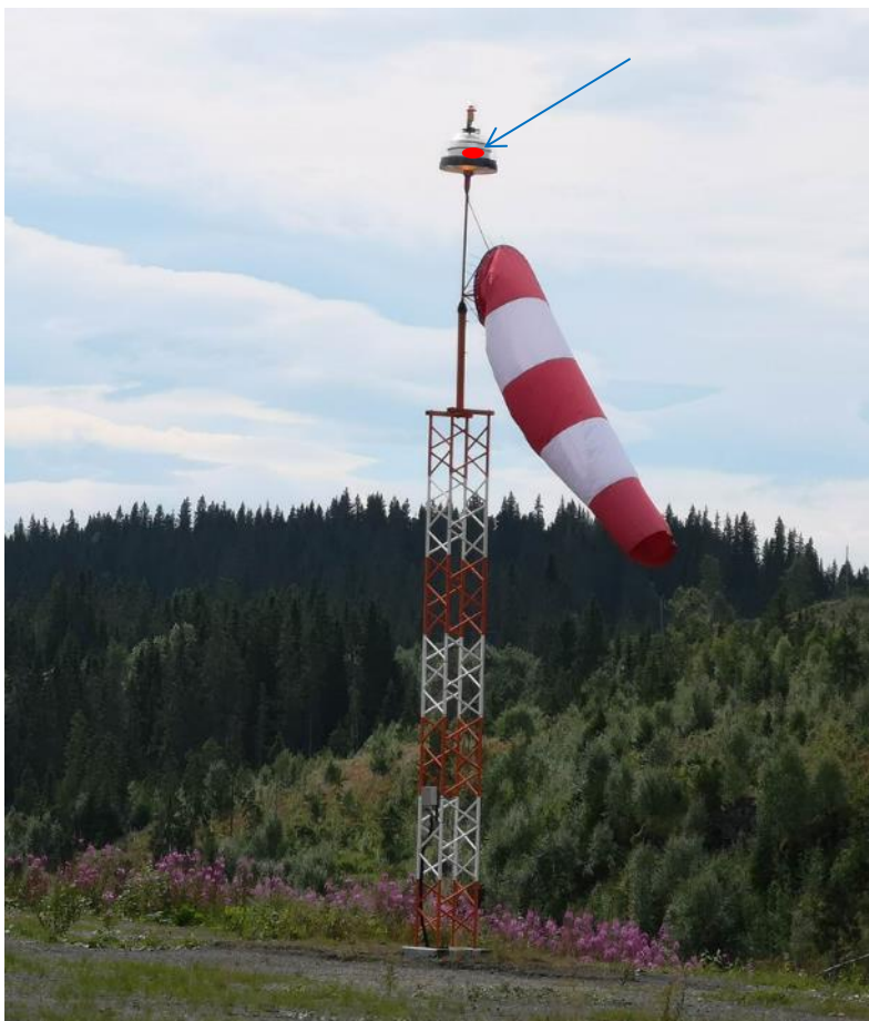
Eksempel på vindpølsebelysning på Mosjøen lufthavn, Kjærstad
