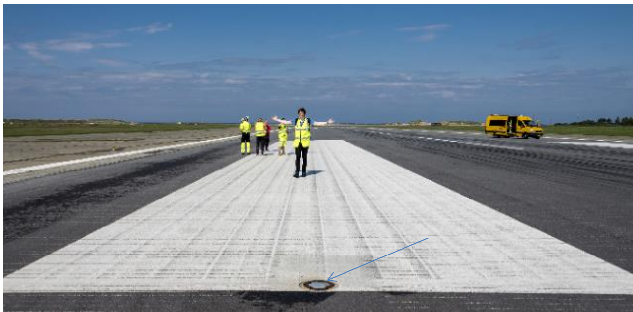
Markeringslys for siktepunkt på Stavanger lufthavn, Sola
