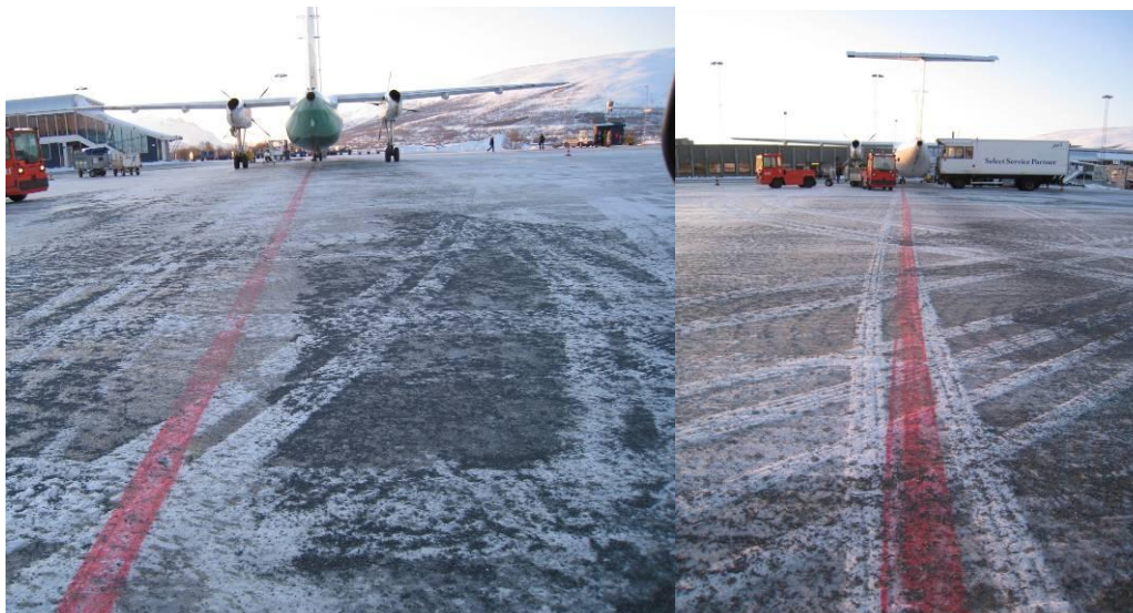
Merking av snø- og isdekt ledelinje på oppstillingsplattform
