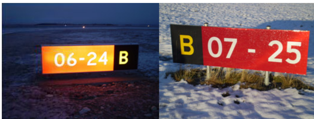
Venteposisjonsskilt for rullebane (opplyst og reflekterende)
